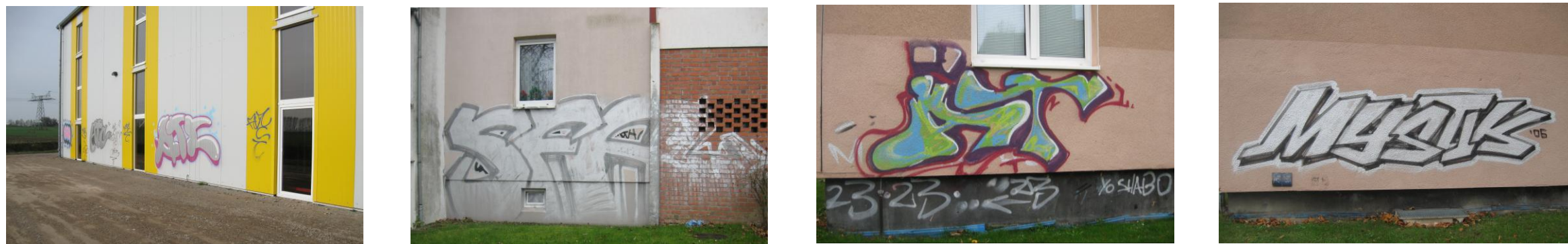
Abb.4: Metalloberfläche Abb.5: Putzoberfläche Abb.6 und 7: Graffiti auf Wärmedämmverbundsystem
