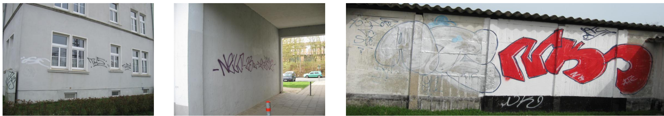
Abb.1: Graffiti an Fassade Abb.2: Wand im Durchgang Abb.3: Garagenrückwand
