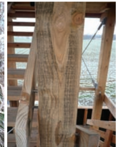
Abb. 7: durch Bläuepilze verfärbte Stütze
