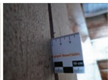
Abb. 3: starker Riss in einer Stütze
