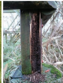
Abb. 6: durch Fäule u. Ameisen zerstörter Stützenfuß
