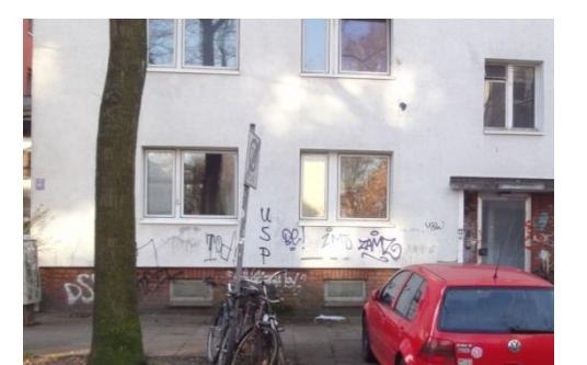
Graffiti auf Fassadenputzen
