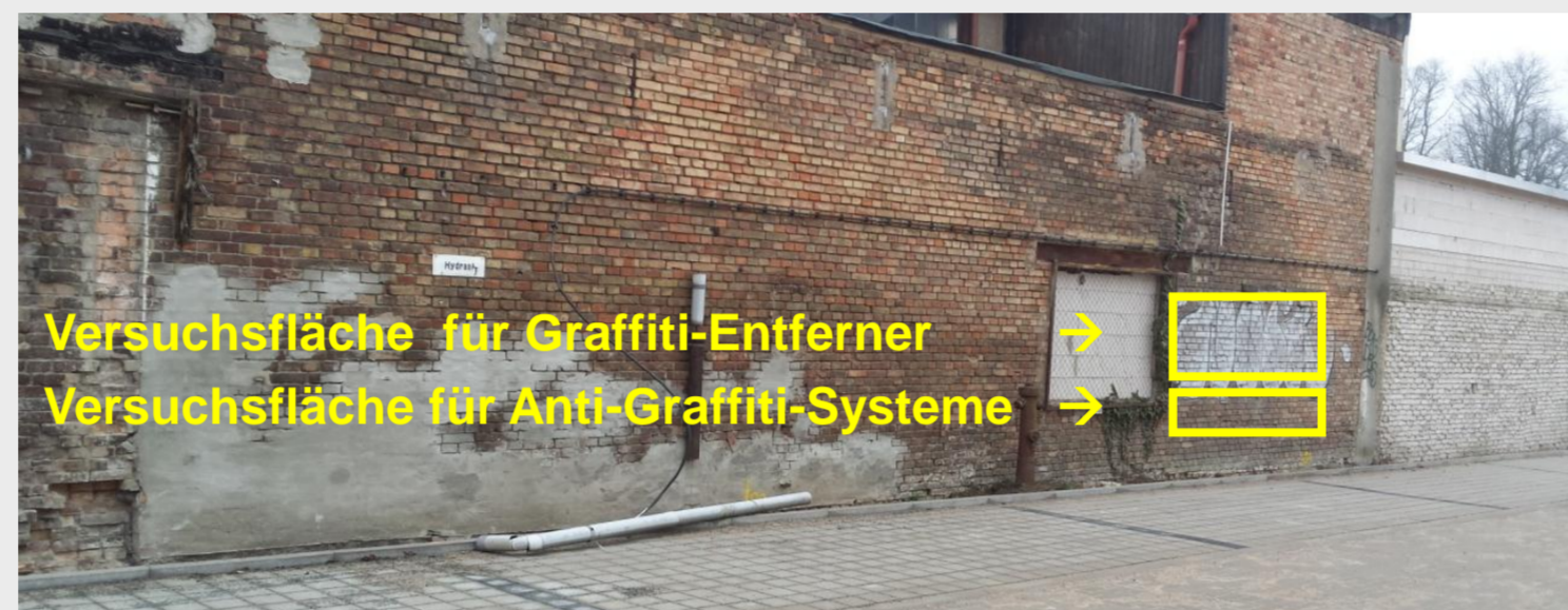
Abb. 1: Ziegelmauerwerk als Außenwand einer Verkaufshalle mit Graffiti-Belastung
