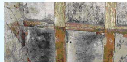
Schimmelpilze im Obergeschoß an der Nordwand.
