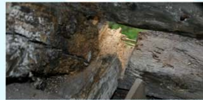
Freilegungsarbeiten: Sanierungsbedarf nach Einwirkung von Faulholzinsekten am Balkenkopf DB12 und Sparrenfußpunkt
