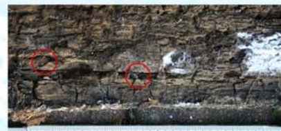
Brettverkleidung der Nordwand - Pilzmyzel, Braunfäule und Insektenbefall; rot markiert: Chitimpanzer u. tote Exemplare des Gescheckten Nagekäfers
