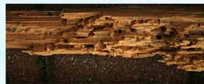
Teil der Brettverkleidung der Nordwand - Braunfäule und Frassgänge mit Kotpillen des Gescheckten Nagekäfers
