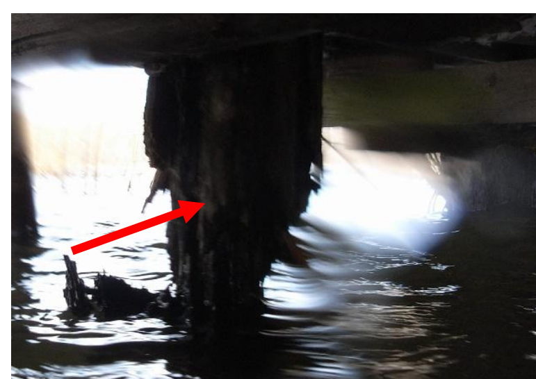
Abb. 4 Durch Moderfäule zerstörter Gründungspfahl
