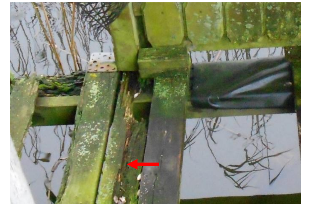
Abb. 6 Braunfäuleschaden im Terrassenbelag
