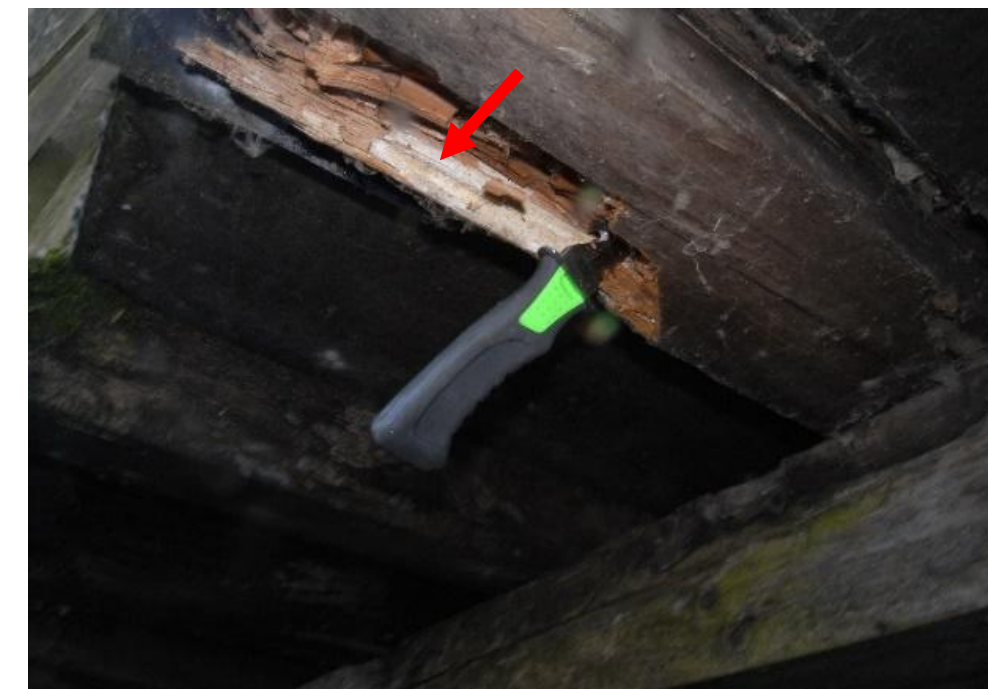
Abb. 5 Braunfäuleschaden im Terrassenlängsträger
